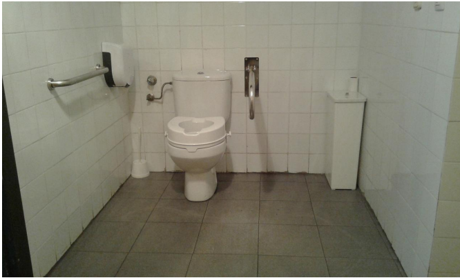
Cabina Aseo Adaptado
